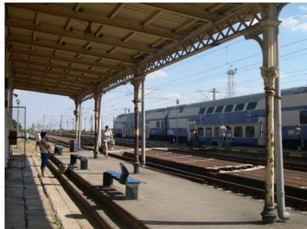
[Fig. 19]. Structura metalică a copertinei Gării din Florești (Băicoi), forme apropiate de cele ale Gării Mogoșoaia.
