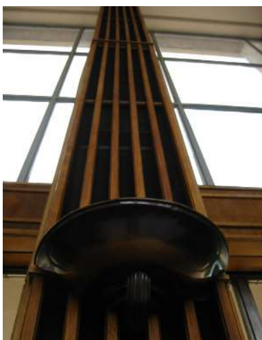
[Fig. 69] Sistemul de ventilație este alăturat pilelor, verticalitatea acestora fiind susținută de corpurile de iluminat.
