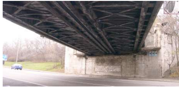
[Fig. 24]. Imagine de detaliu a fostului pod de la Băneasa, structură demolată în 2006. Se vede tablă metalică și pila din beton armat placată cu travertin.
